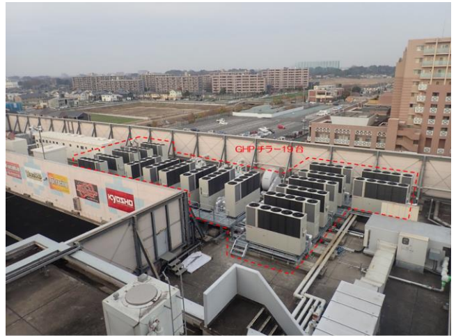
更新後熱源機器
